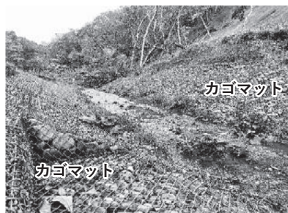
図4b 環境保護事例②(廃止ため池E)
