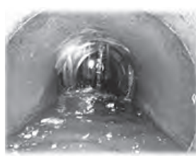
幹線水路(サイフォン)の劣化状況
