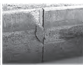
幹線水路の劣化状況
