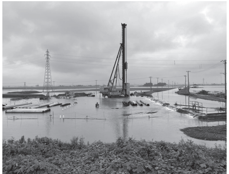
西野排水機場付近の浸水状況
