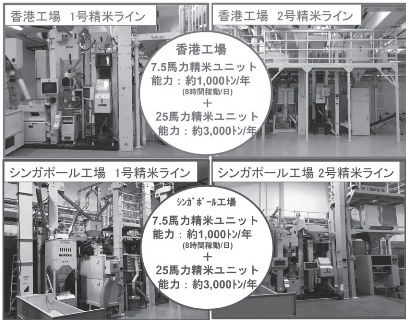
図2 現地に設置した精米設備
