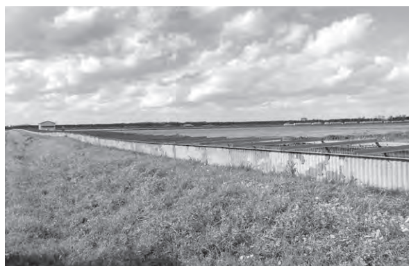
図1 八郎湯地区における不同沈下
