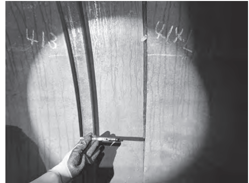
Pic. 1 継手間隔異常
