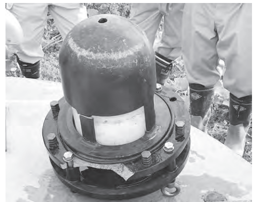
Pic. 3 空気弁の離脱
