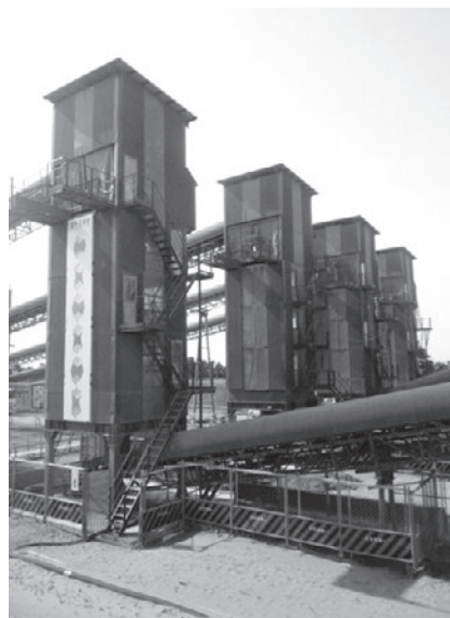
図2 CSG混合設備
