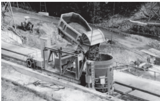
自動化されたトランスファーク
