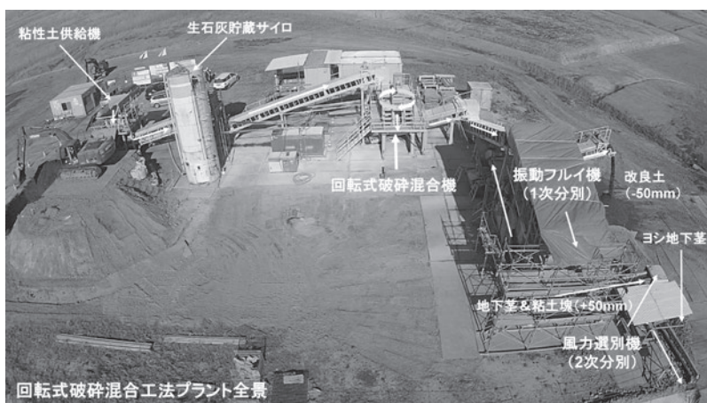
図7 プラント全景
