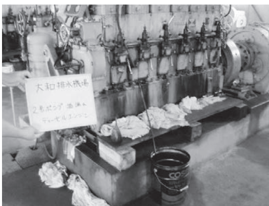
写真2 ポンプ設備の油漏れ
