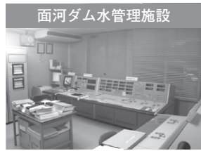
水管理施設の劣化
