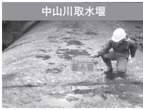
固定堰の摩耗
