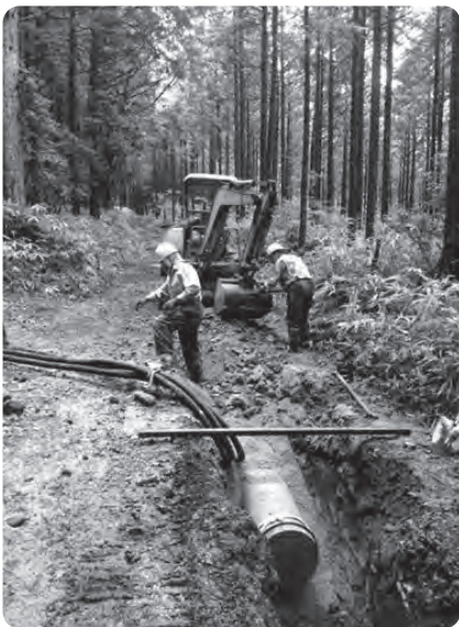
水圧管路 (土中埋設)
