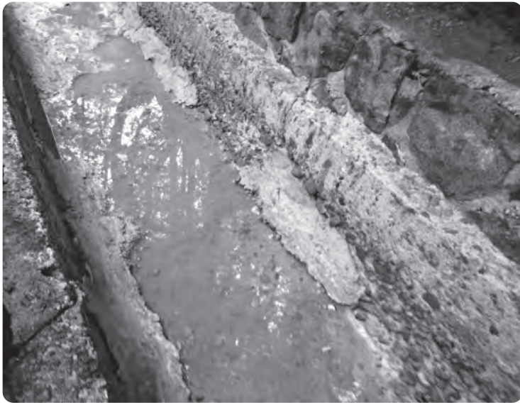
老朽化した導水路の内面
