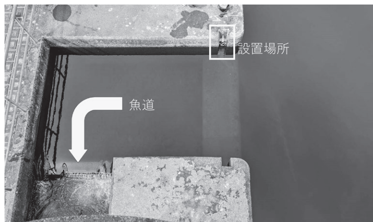
図2 渡良瀬川太田頭首工観測システム設置位置
