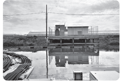
写真1 水上太陽光発電施設
