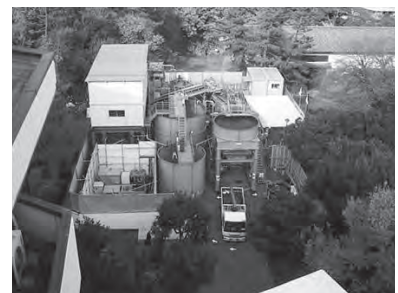
写真2 脱水処理プラント全景
