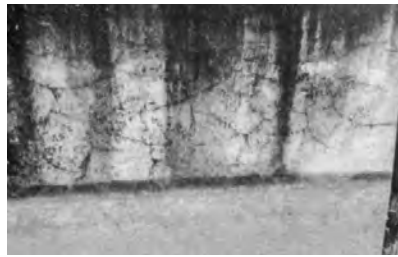
Photo 2 微細ひび割れ
