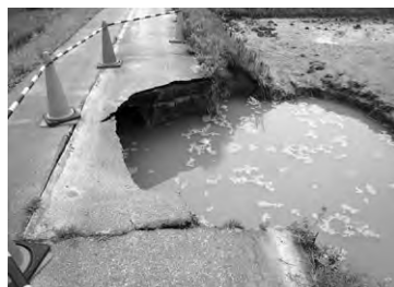
支線用水路の漏水
