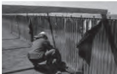
腐食が進む幹線用水路
