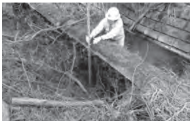
支線排水路背面土砂の流出
