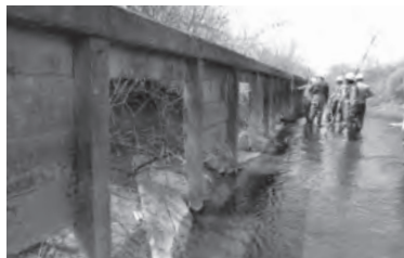
支線排水路の欠損
