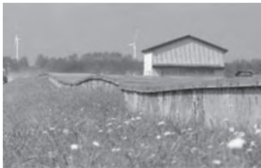
不同沈下によりたわんだ幹線用水路
